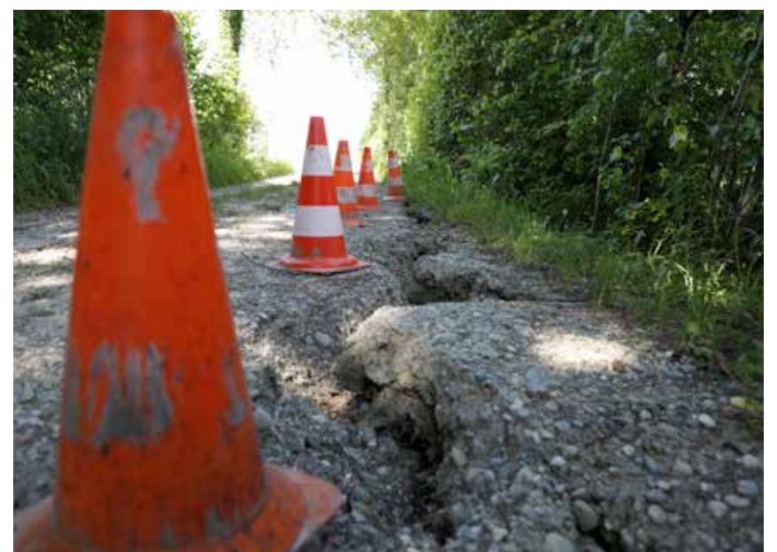
Keine neue Schlucht im Eulachtal, sondern nur ein harmloser Riss im Flurweg. Bild: Jonas Manser
